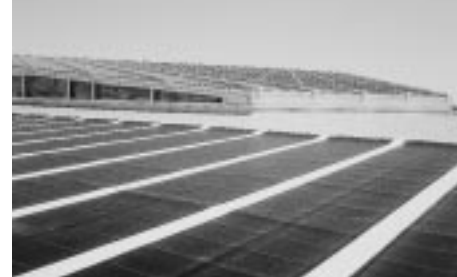
Abb. 4: Dachbahn mit amorphen Solarzellen
